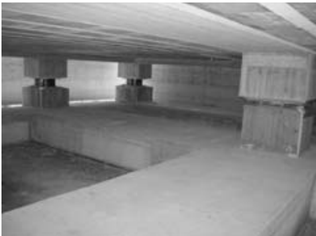
Figura 20: Vista di 2 HDRB ed 1 SD installati nel vano interrato del nuovo corpo di fabbrica "B" del liceo di Figura 16.
