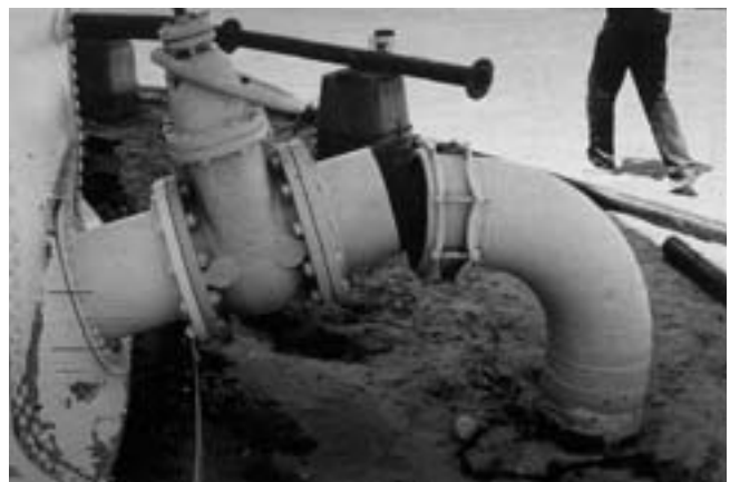
Figura 3: Terremoto di Landers (USA, 1992) – Rottura delle connessioni tra tubazione e serbatoio.
