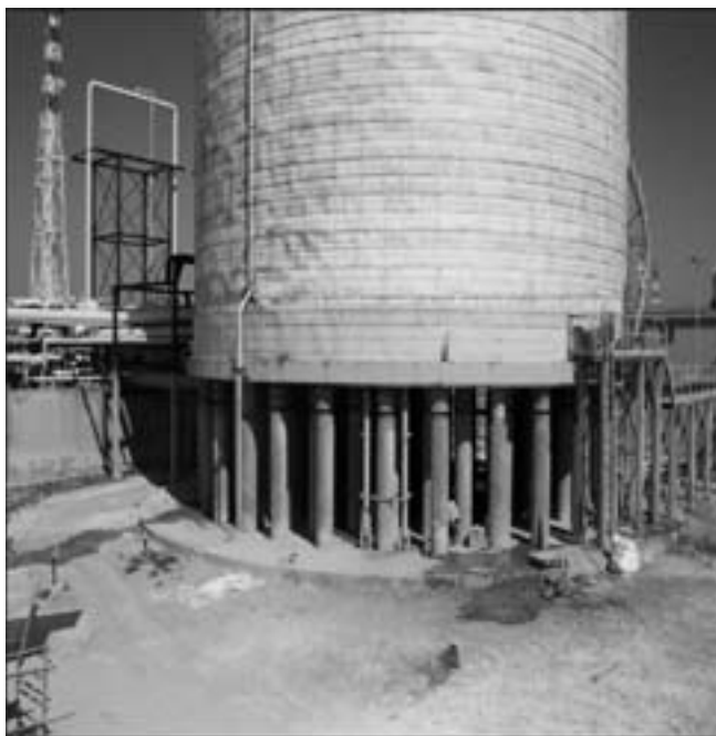
Figura 6: Uno dei tre serbatoi cilindrici criogenici in cemento armato della società Polimeri Europa del gruppo ENI situati a Priolo Gargallo, che sono stati adeguati sismicamente con isolatori FPS negli anni 2005-2008.
