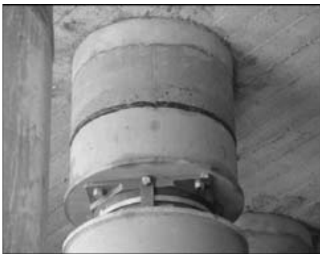
Figura 7: Un isolatore FPS installato nel serbatoio di Figura 6.
